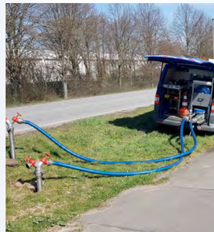
Lecksuchbus im Einsatz
